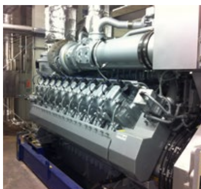
Blockheizkraftwerk im Kühlhaus
