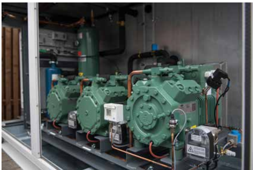
Blick in das Innenleben der klimatisierten Kälteanlage von KMW.
