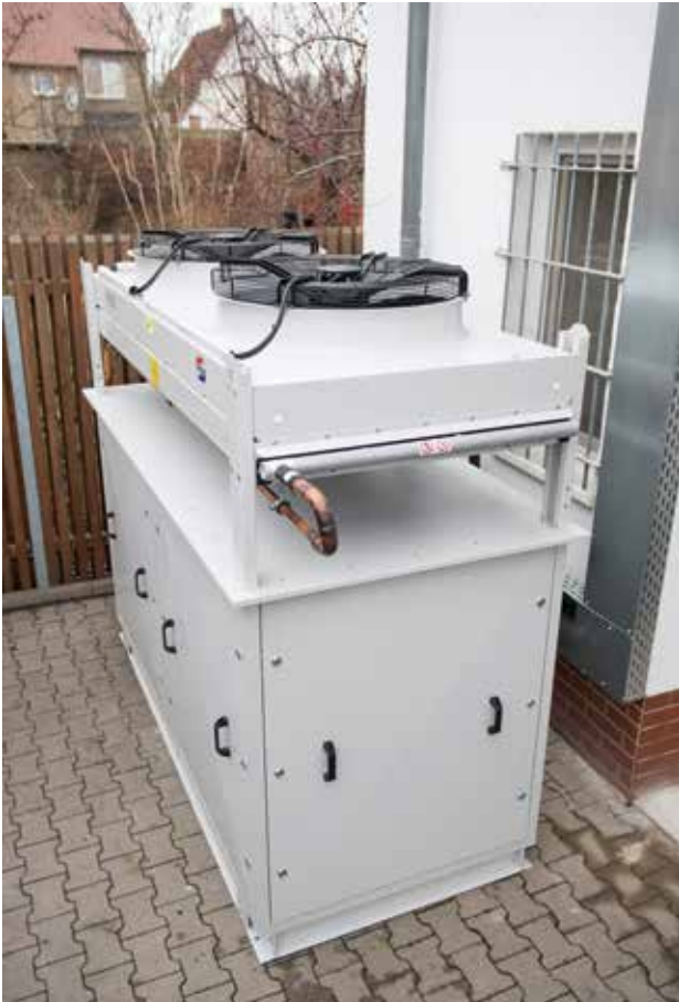
Die klimatisierte Kälteanlage mit Verkleidung.
