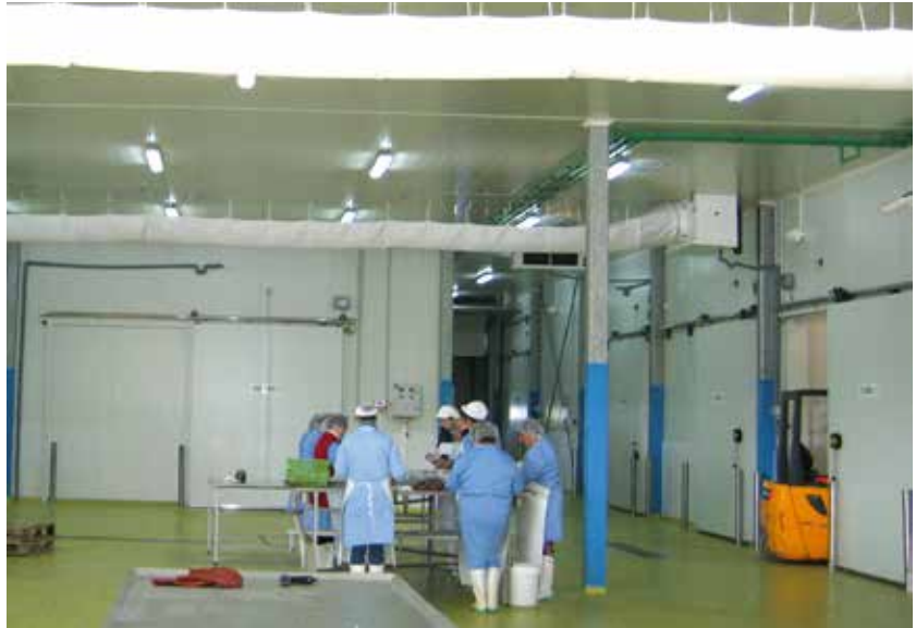
Die kalte Luft aus den kubischen Güntner GHN-Luftkühlern strömt über Textilschläuche in die Arbeitsräume.
