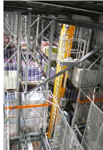
Die neue doppeltiefe Gasse in der Hochregallager-Erweiterung.
