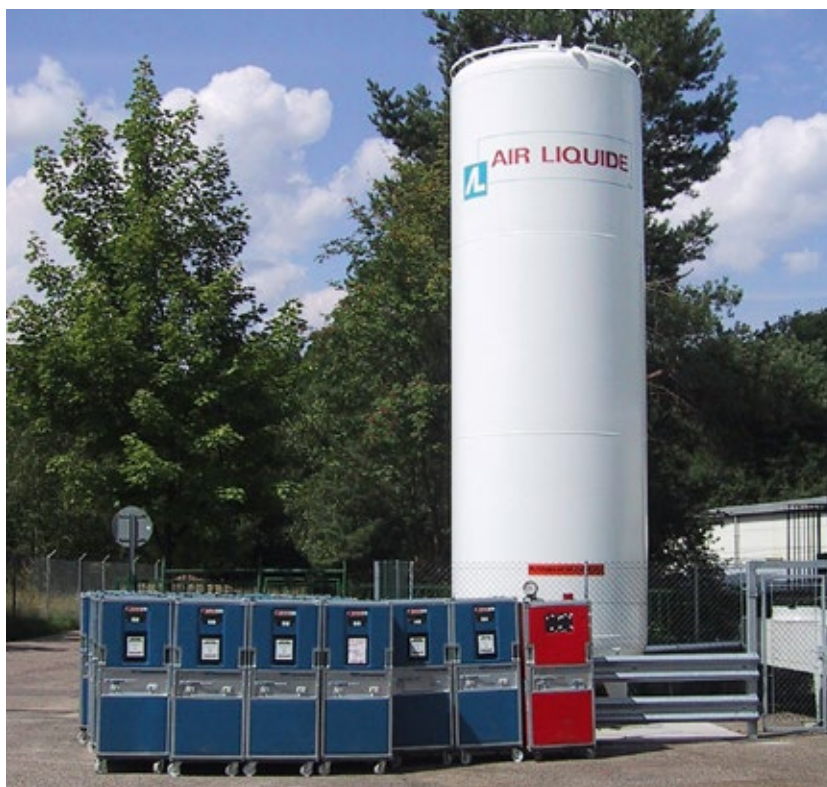
Tankbehälter für flüssiges CO 2 und Isotainer von TKT.
