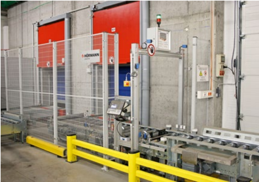
Ein manueller Palettenaufsatzplatz im Neubau des Hochregallagers.
