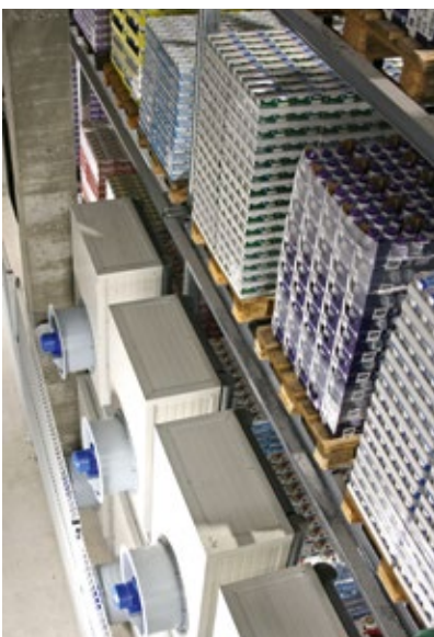
Im Neubau des Hochregallagers gibt es auch Schnellkühlplätze.
