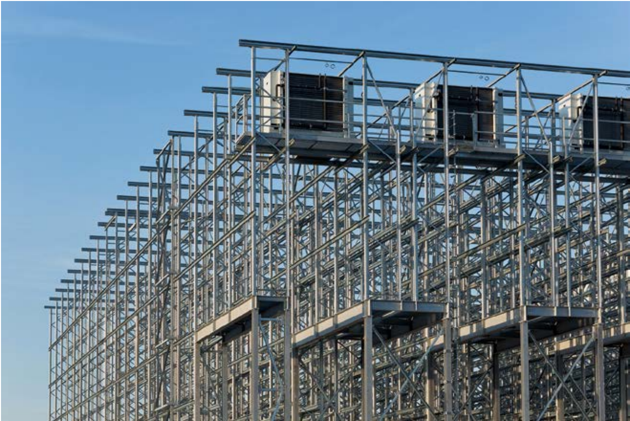
Die Kühlaggregate sind in das Siloregal integriert.
