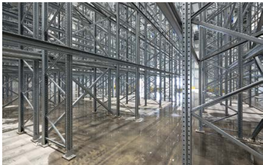
Omega-Steher und Sigma-Palettenträger: 500 Tonnen Regalprofile tragen Isolierpaneele und Kältetechnik.
