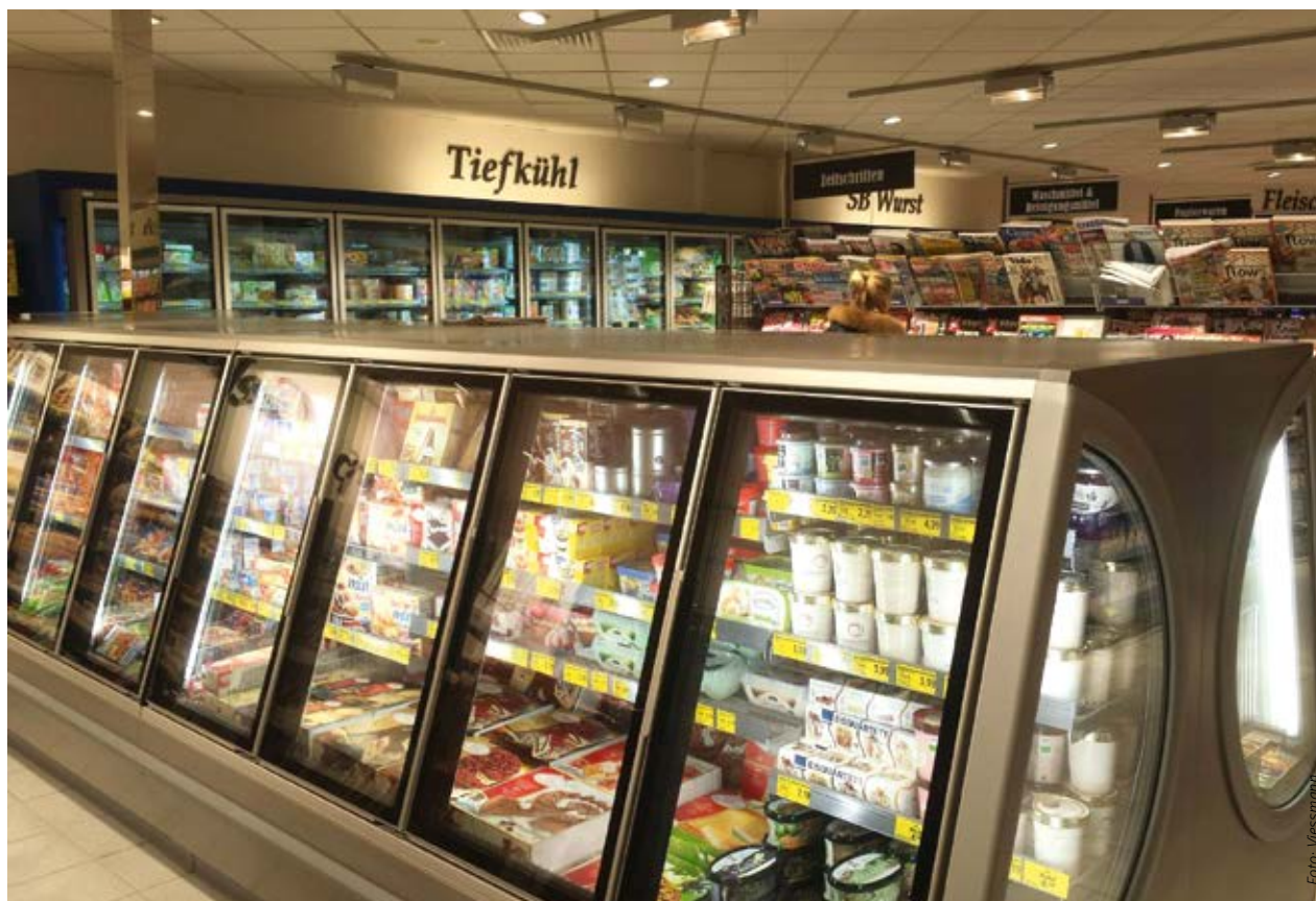
Der Tiefkühlschrank Iconic beim Edeka Schlemmer Markt Struve in Hamburg.
