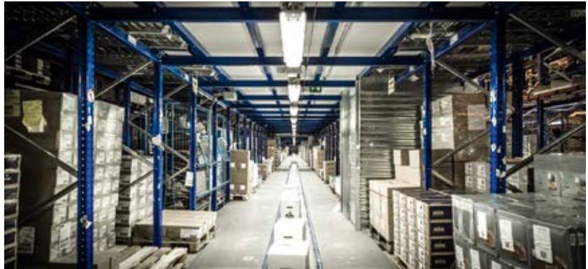
Die Kommissionierung erfolgt bei Coldstar als Tunnelkommissionierung auf vier Ebenen mit circa 3300 Pickplätzen.
