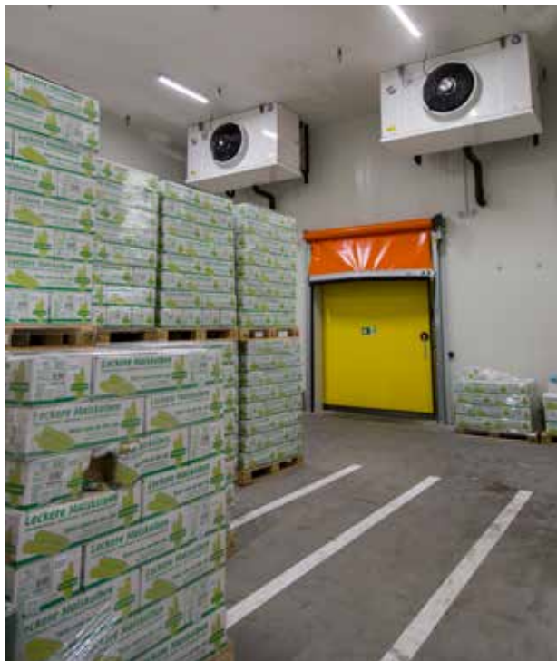
Zwei Tiefkühlräume werden über fünf Güntner CO 2 -Direktverdampfer, Typ CXGHN, versorgt. Die Abtauung erfolgt über einen separaten, integrierten Warmsolekreislauf.
