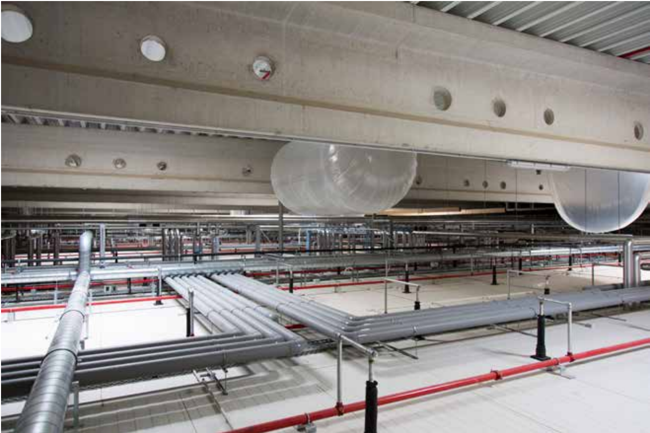
Die umfangreiche Verrohrung, die Luftsäcke der CA-/ULO- Druckausgleichsanlage sowie die Trockensprinkler-Anlage befinden sich oberhalb der Lagerräume.
