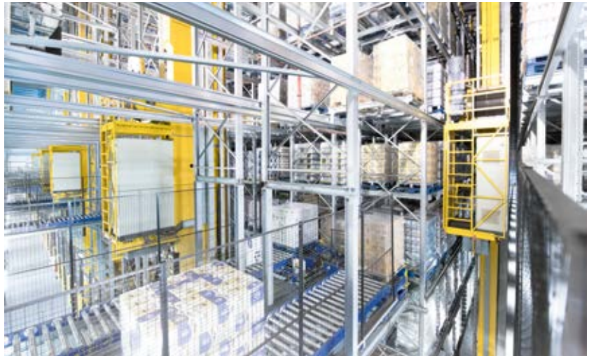
Im Hochregallager brachte SSI Schäfer die Laufschielen für die Regalbedien- geräte in den elf Gassen des 32 Meter langen Anbaus ein.
