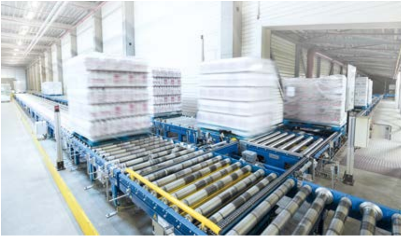
Auf der zweiten Geschossebene werden die Paletten von der Palettenförder-technik zum Hochregallager transportiert.
