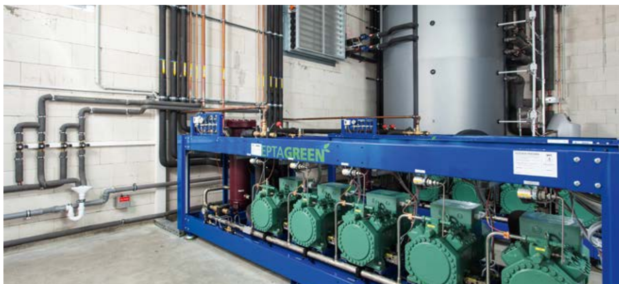
Beispiel einer transkritischen Kälteanlage als Alternative für von der F-Gase-Verordnung für das »Phase Out« vorgesehene Kältemittel.
