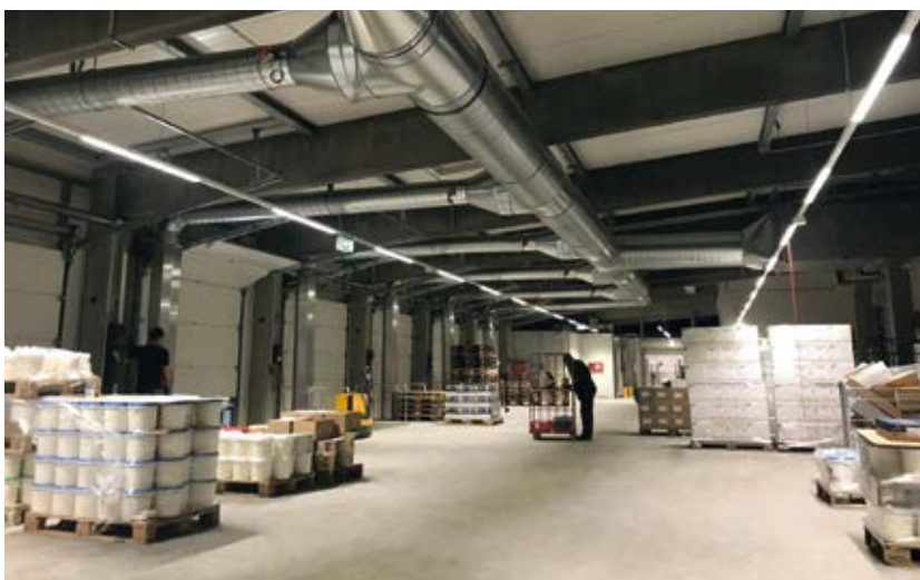
Bei Wehner Gronau wurde sichergestellt, dass die Kühllhalle an jedem Tor vor einströmender Warmluft geschützt ist.
