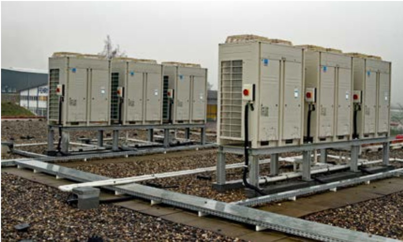
Insgesamt 15 Zeas-Systeme von Daikin mit einer Gesamt-Kälteleistung von 502,4 kW versorgen die Kühlflächen.
