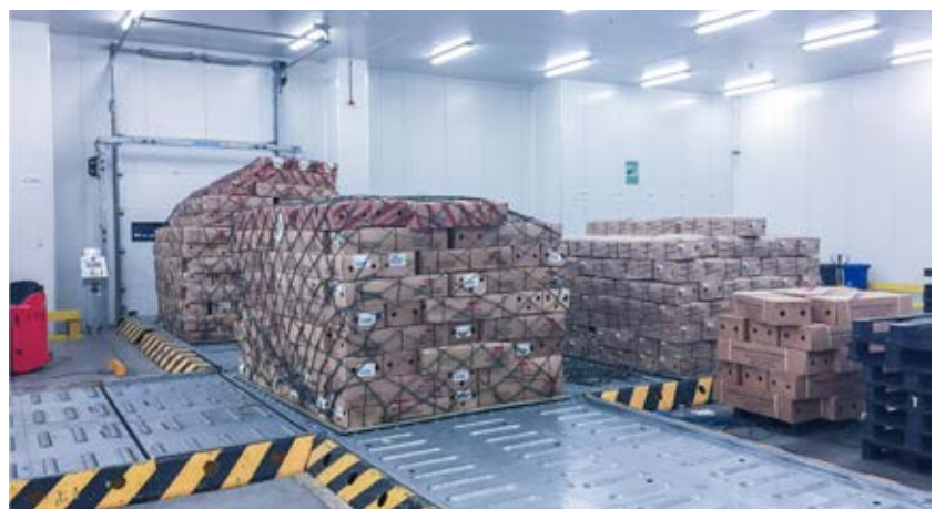
Die Kühlung der kompletten Hallenfläche von den Toren auf der Airside bis zu den LKW-Rampen auf der Landside gewährleistet die Einhaltung der Kühlkette.
