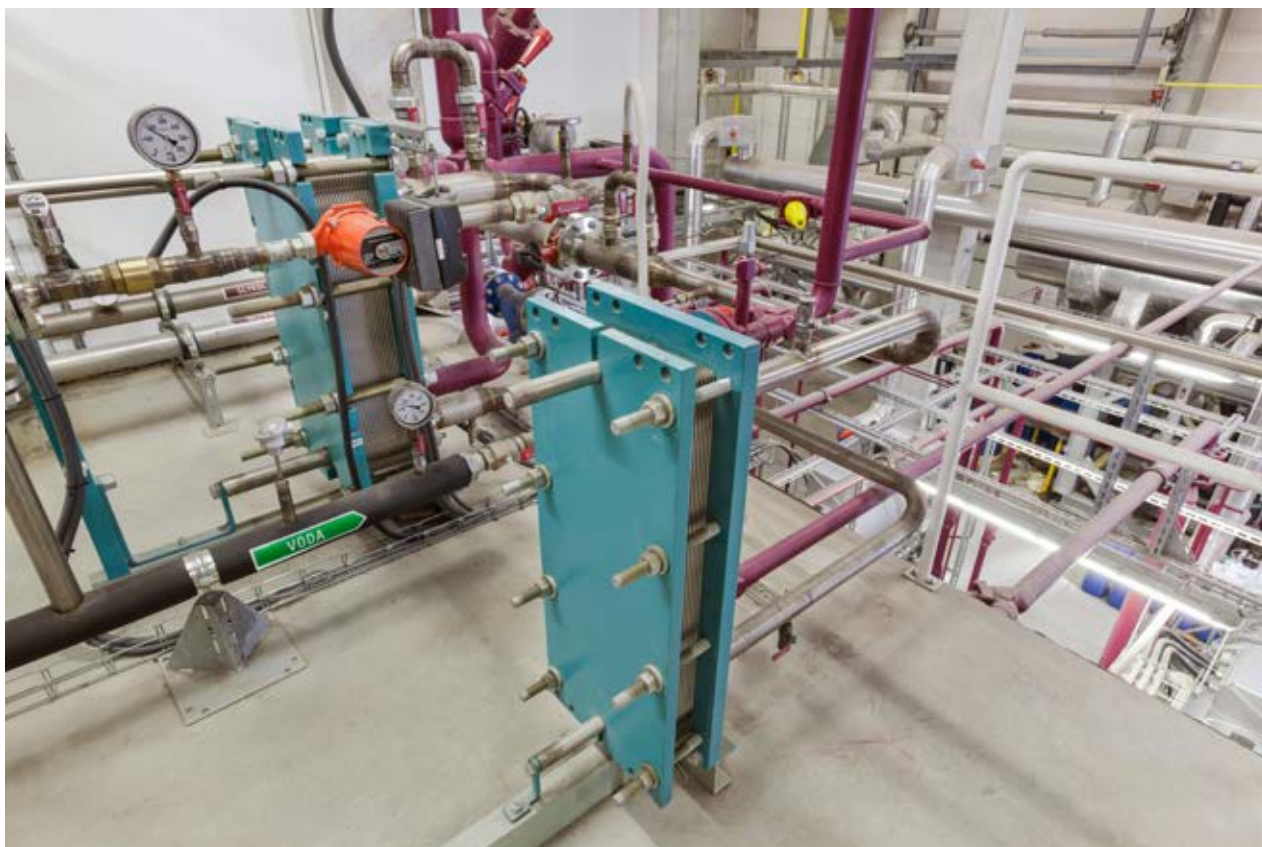
Ein leistungsstarker Thermowave \text{NH}_3 -Plattenverdampfer kühlt den Glykolkreislauf für die Versorgung von Luftkühlern (hinten) und ein weiterer Thermowave Plattenwärmeaustauscher (vorne) versorgt die zentrale Lüftungsanlage für Büroräume.
