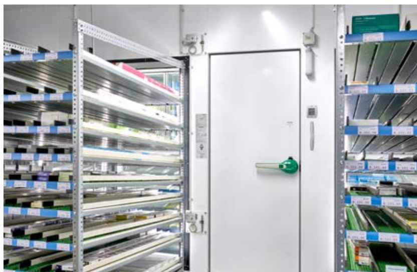
Beide Kühlzellenkomplexe sind begeh- und befahrbar, was die Bestückung enorm vereinfacht.
