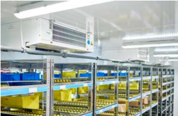
In jedem Kühlzellenkomplex sorgen sechs Verdampfer für eine optimale Verteilung der Kälte.
