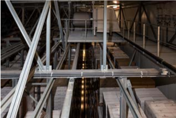
Die neun Highstore Application Luftkühler im Tiefkühl-Lageraum stehen in 36 Meter Höhe oberhalb der Regaloberkanten auf einer Bühne.
