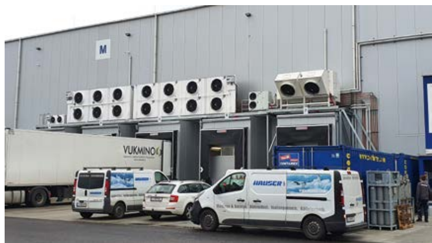
Nach der Bauphase überwacht das Servicecenter von Hauser laufend die Betriebsparameter der neuen Anlagen, auch um Vorschläge für Systemoptimierungen zu liefern.
