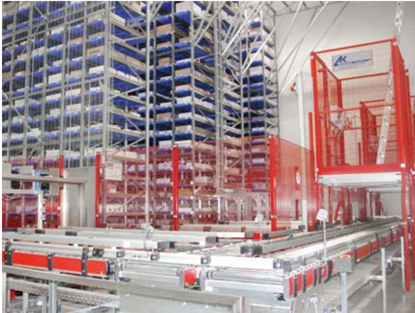
Das automatische Tiefkühlager in Tablartechnik mit Vorzone.
