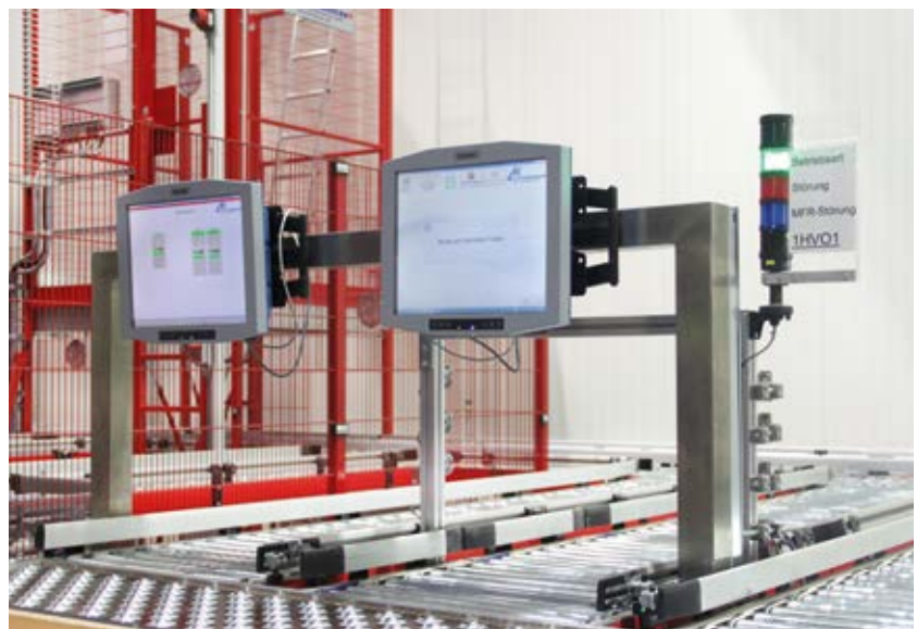
Kommissionierarbeitsplatz in der Fördertechnik-Vorzone mit Warehouse Management System.
