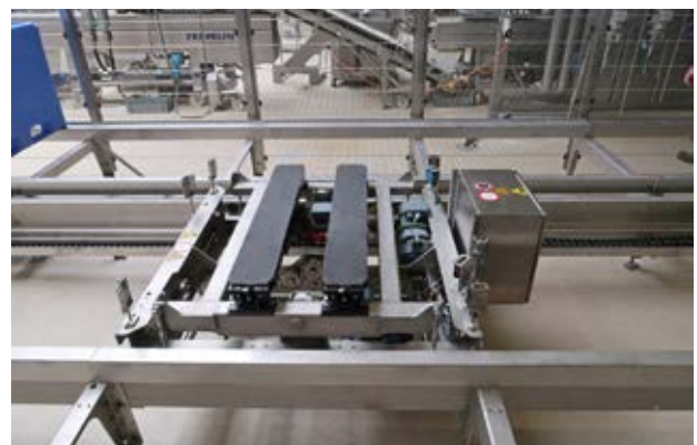
Der Transport innerhalb der Anlage wird von einem Spezial-Transferwagen zwischen den beiden Lagerblöcken übernommen.
