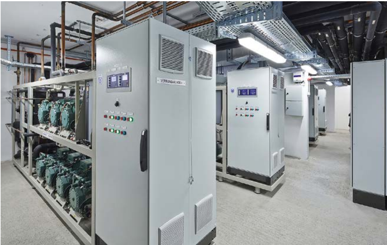
Die Kälteerzeugung in den neuen Lagerhallen wird durch zwei getrennte Anlagen dargestellt.
