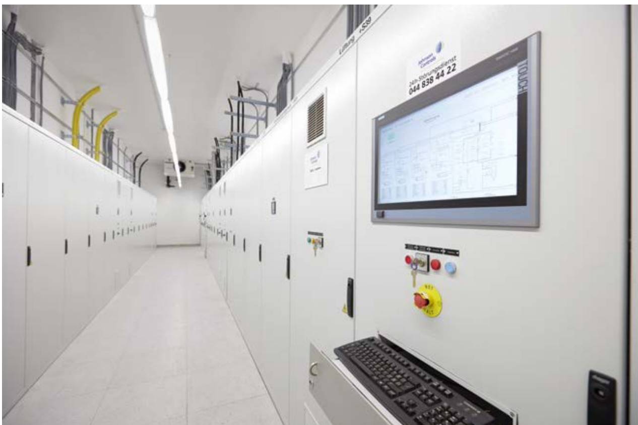
Schaltschrankraum mit Leitsystem Bedienung.
