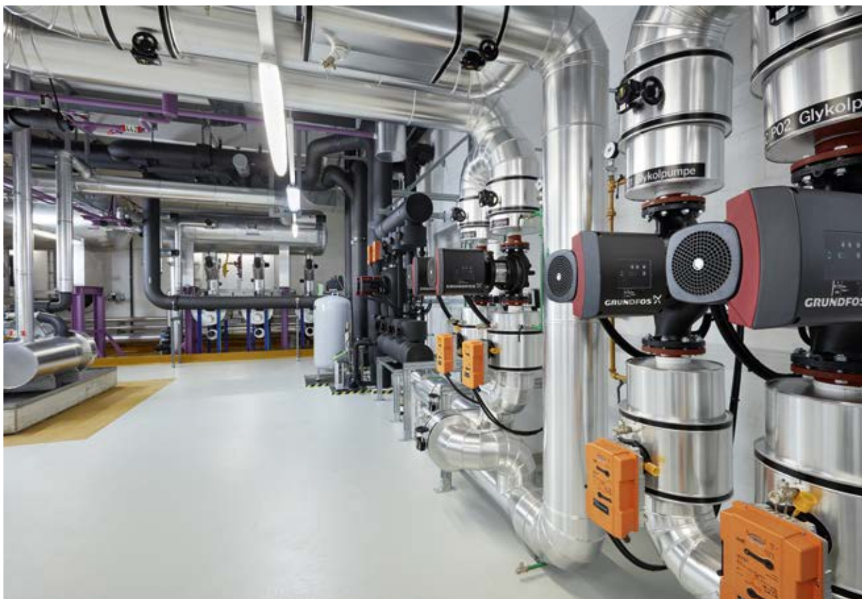
Pumpenverteilung Abwärmenutzung und Glykol.
