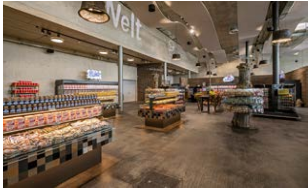
Hauser verbaute in Asbach-Bäumenheim insgesamt 80 Meter Wandkühlregale, 40 gekühlte Palettenstellplätze sowie mehrere Kühlgondeln.
