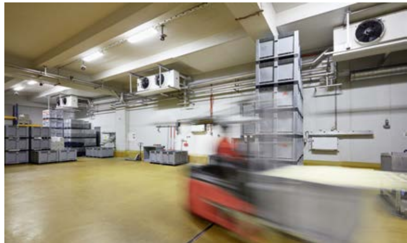
Tiefkühlraum mit Ammoniakverdampfer.
