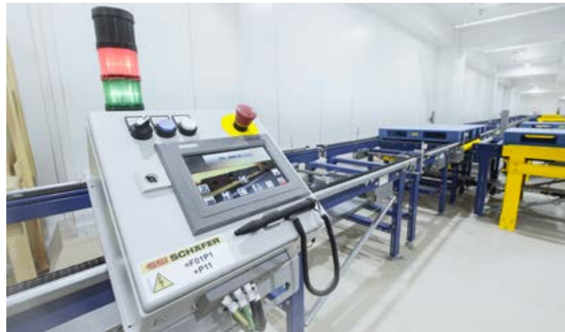
Der Leistungsumfang von SSI Schäfer für das Projekt beinhaltet eine Förderanlage, Pick to Tote Kommissionierarbeitsplätze, ein vollautomatisches Hochregallager und die Logistiksoftware Wamas.
