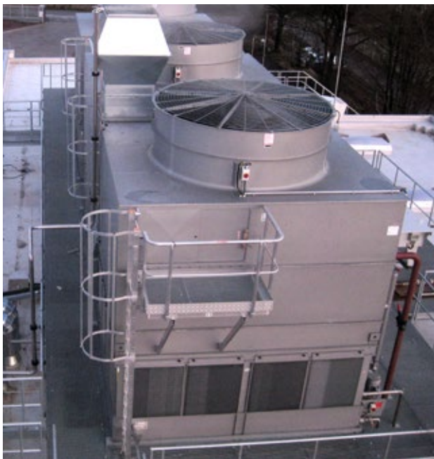
Verdunstungskühlanlage eines Kühlhauses
