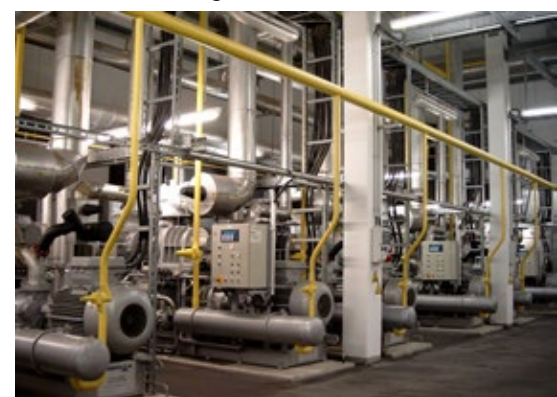
Ammoniak-Kälteanlage eines Kühlhauses
