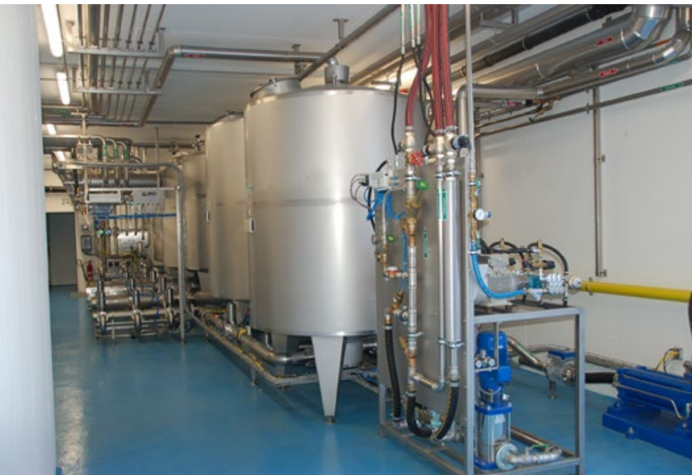
Standardisierte Prozesse mit leitwertgesteuerten Medienströmen – die zentrale Versorgungsanlage im Untergeschoss.
