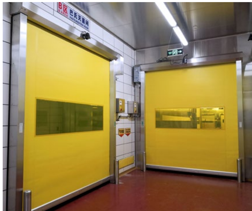
Für die Produktion von Tianjin Guoshun Meat Food wurden alle Tore und auch die Steuerschränke komplett in rostfreiem Edelstahl ausgeführt.
