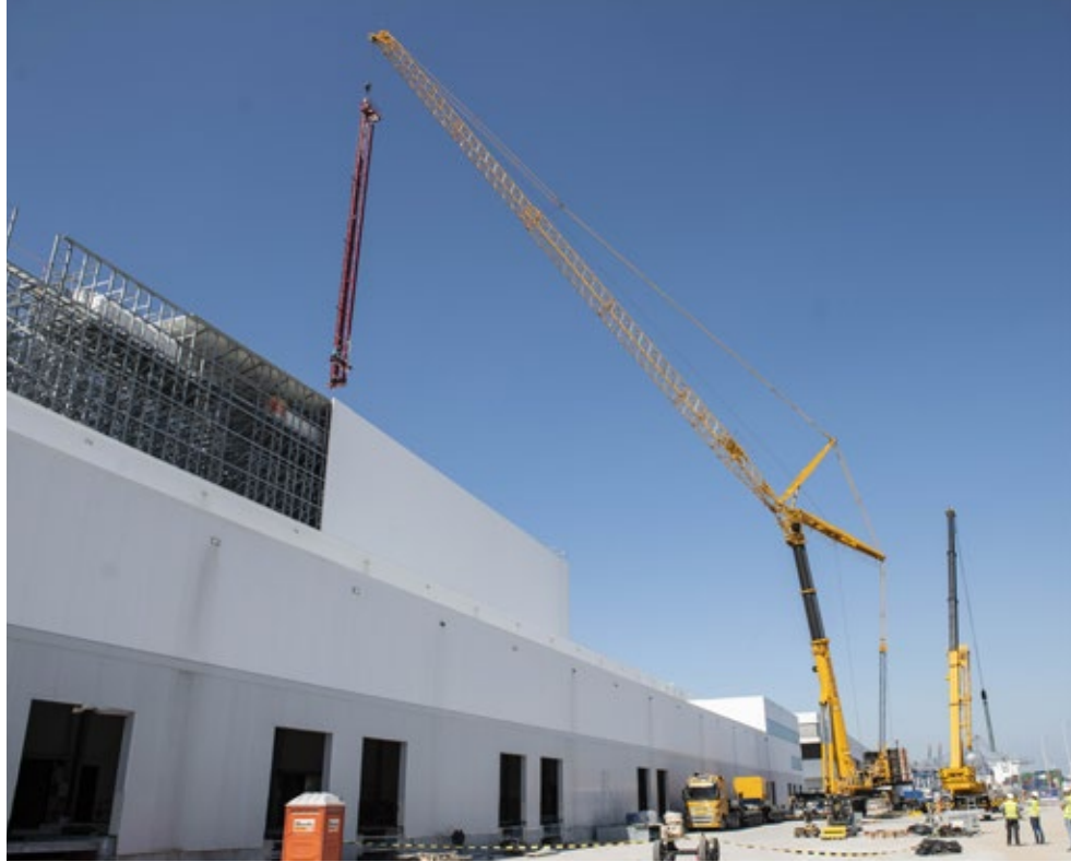
Wesentlicher Grund für Westfalias Erweiterung ist die Höhe heutiger RBG wie hier bei einem Projekt für Kloosterboer in Rotterdam zu sehen: Sie überschreitet immer öfter die 40-Meter-Marke.
