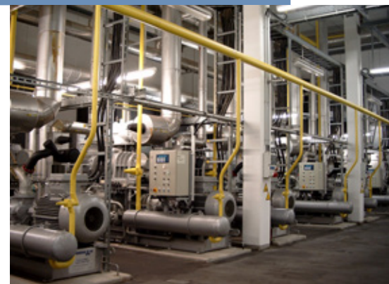
Ammoniak-Kälteanlage im Kühlhaus
