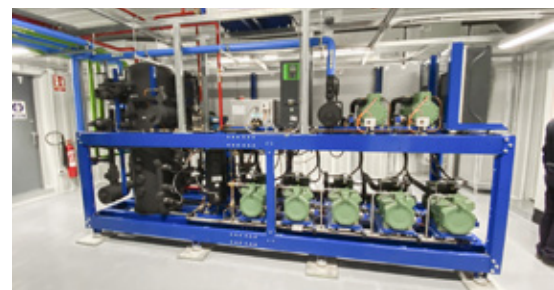
Die Verbundanlage im Consum Markt im spanischen Benicasim beinhaltet sowohl das System FTE 2.0 als auch das ETE-System von Epta.
