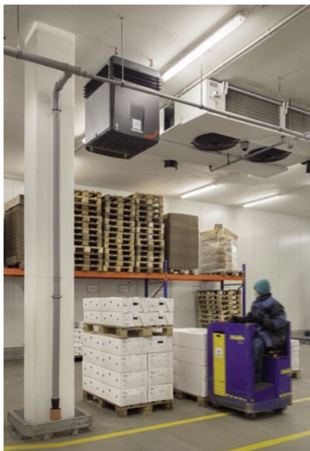
Installiert wurden die Luftreinigungssysteme als Deckenmontage unmittelbar in den Bereichen mit hoher Staubbelastung, zum Beispiel am Warein- und -ausgang in der Bereitstellungs-halle.
