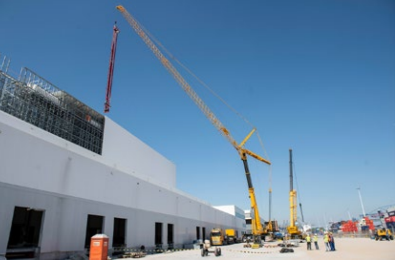
Das sechsgassige vollautomatische Tiefkühl-Hochregallager Cool Port 2 ist 69 Meter lang, 139 Meter breit, 41 Meter hoch und umfasst 60 000 Regalstellplätze.
