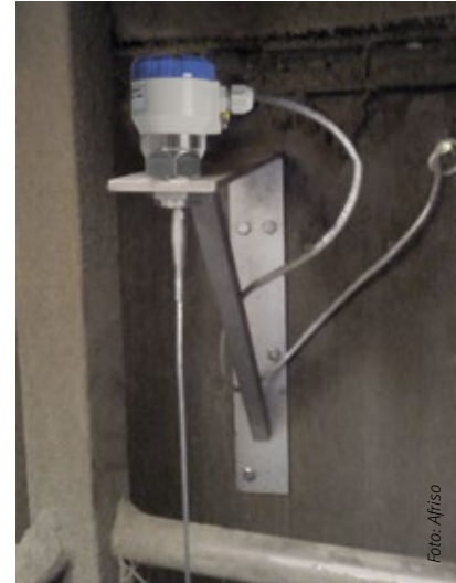
Bei einem Trester-Silo kommt die Afriso Messgeräteserie Pulsfox PMG 20 MF zum Einsatz, das im Silo oben eingebaut wurde.
