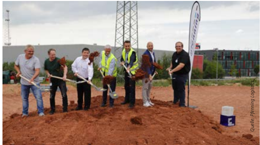
Beim Spatenstich (von links): Frank Theune, Beisheim Bebra GmbH & Co. KG, Jens Fleischhauer, Projektleiter bei Klebl GmbH, Thomas Fehling, Bürgermeister der Kreisstadt Bad Hersfeld, Karl Friedbert Herbst, Geschäftsführer von HFL Herbst Frischelogsitik, Martin Königstein, Geschäftsführer von Pfenning Logistics, Manuel Pfenning, Geschäftsführer von Pfenning Logistics, Torsten Radszuweit, Leiter Zentraleinkauf und Immobilien bei Pfenning Logistics.
