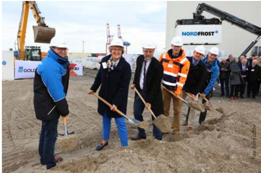
Ein weiterer Spatenstich am Nordfrost Seehafen Terminal. Von links: Philipp Brandstrup, Niederlassungsleiter von Nordfrost am Seehafen-Terminal, die beiden Nordfrost-Geschäftsführer Britta Bartels und Dr. Falk Bartels, die Bauunternehmer Christian Janssen (Matthäi) und Jesper Strube (Goldbeck) sowie Peter Wilke, technischer Leiter von Nordfrost.
