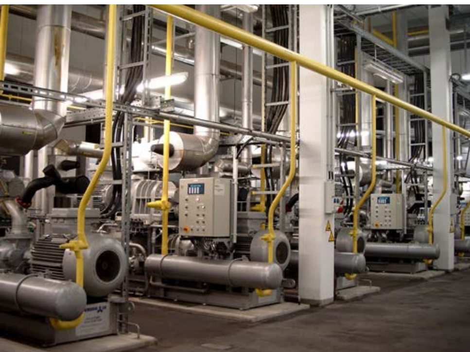
Kälteanlage in einem Kühlhaus
